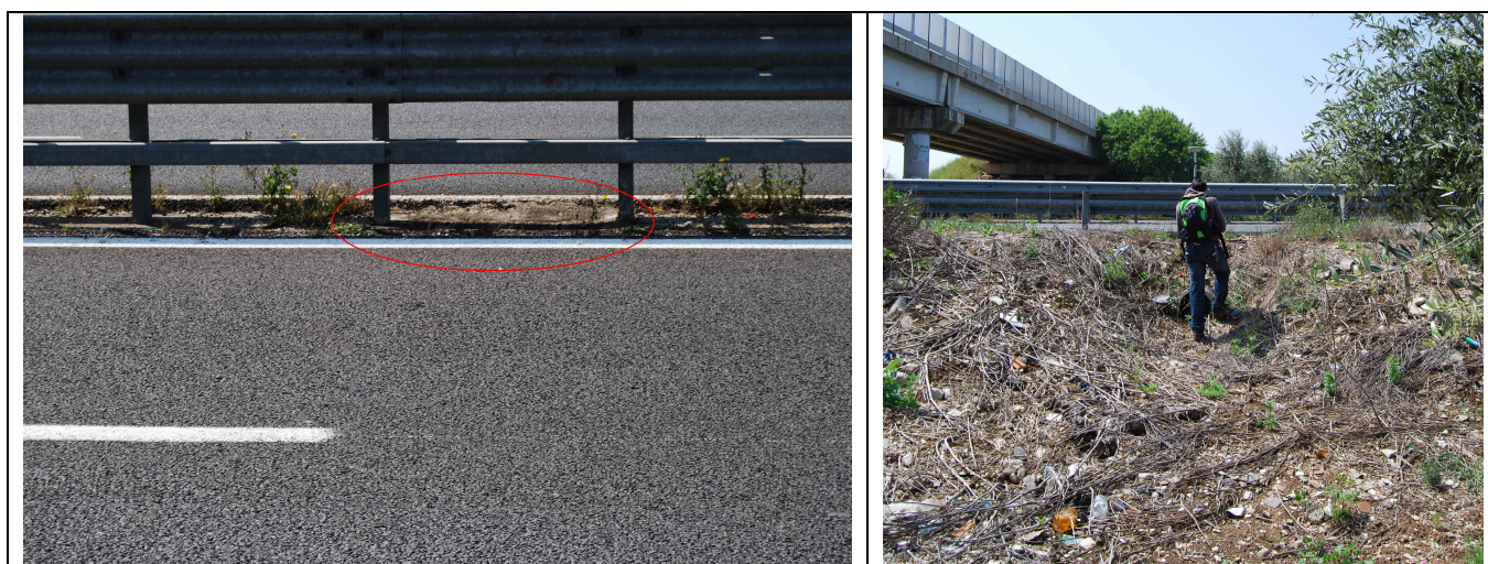
Nella prima foto è raffigurata la caditoia sulla piattaforma stradale che allontana le acque verso valle, attraverso la tubazione indicata nella seconda foto.
